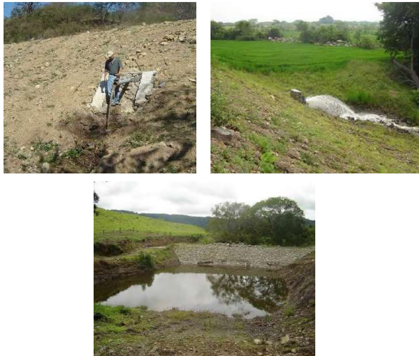
Figura 3. Izquierda: obra de toma azolvada, centro: obra de toma no azolvada, derecha: Bordo vacío con entrada de obra de toma expuesta, pero en operación. Fuente: Elaboración propia fotografías tomadas en octubre 2019.
